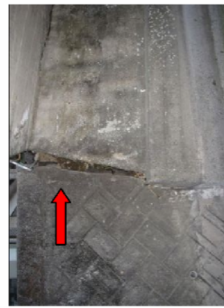
沈下、移動、傾斜
