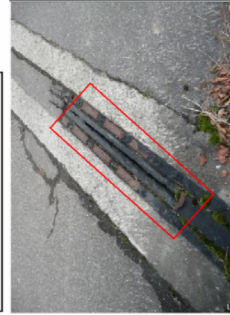
伸縮装置の変形、欠損
