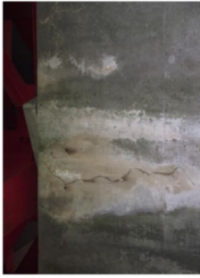
橋座のひびわれ
