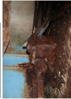
支承の機能障害
