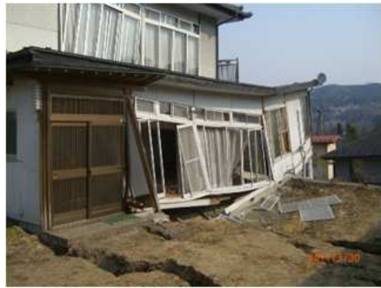
写真2 地震による被害例
